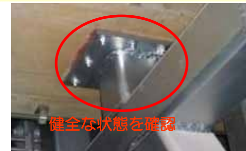
配管支持構造物
