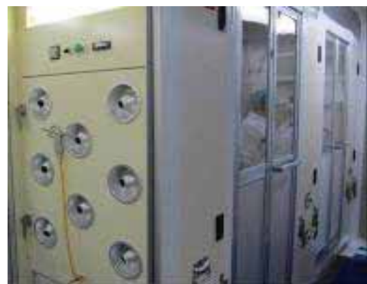
休憩所内エアシャワー
