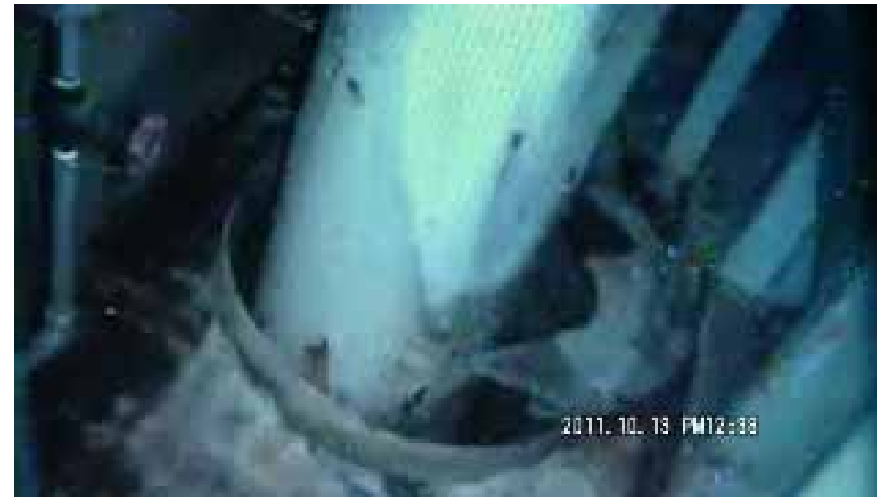
10月13日撮影の1階床貫通部 の状況(蒸気放出無し)
